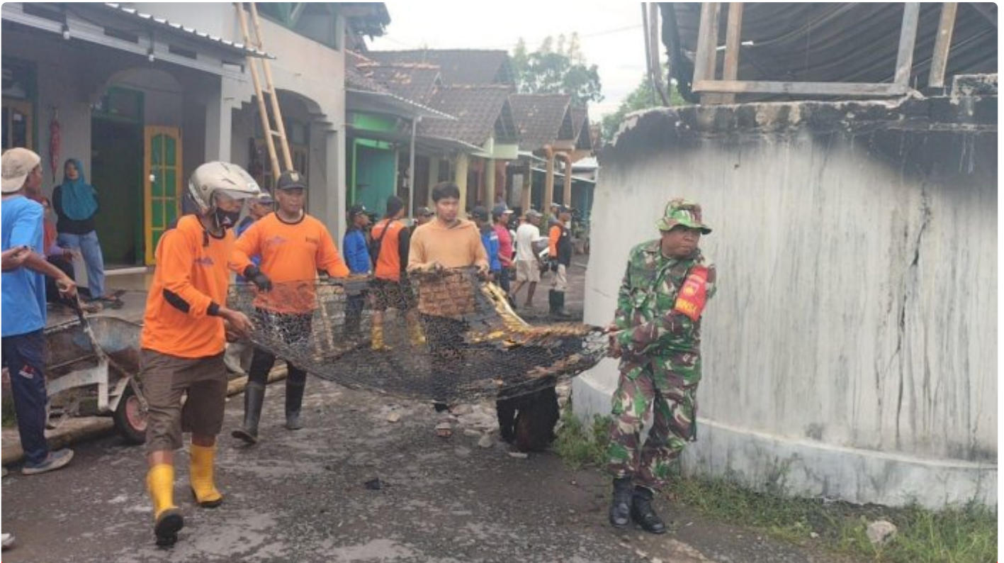
Babinsa Koramil 09 Prambanan Bantu Warga Bersihkan Puing Puing Pasca Kebakaran
